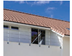
雨水の浸入防止
